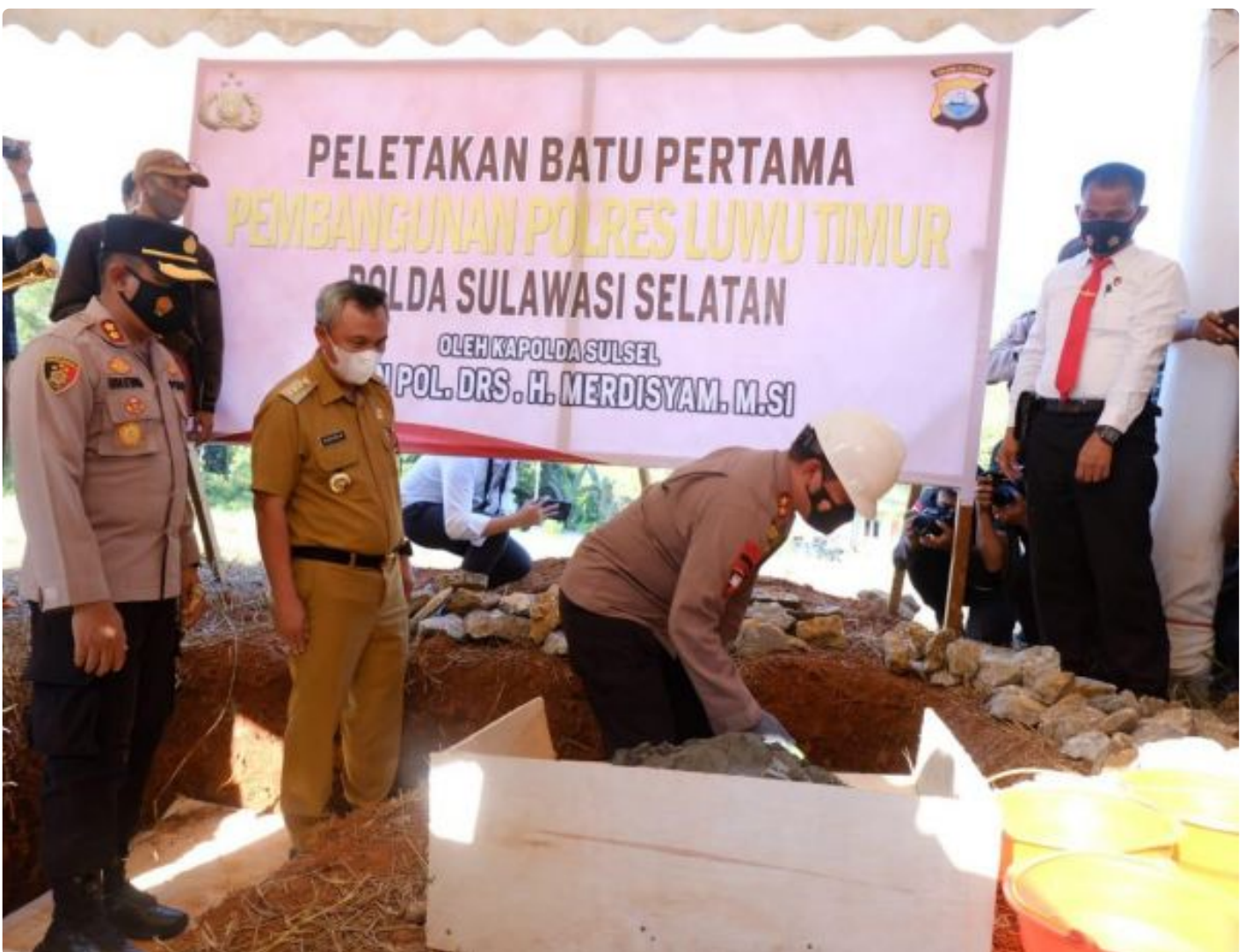
Kapolda Sulsel Irjen Pol Merdisyam meletakkan batu pertama pembangunan Markas Komando (Mako) Polisi Resort (Polres) Luwu Timur (Lutim)
