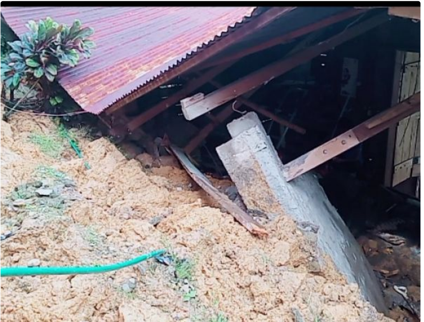
Rumah Warga yang Tertimpa Longsor, Sabtu (8/5/2021).
